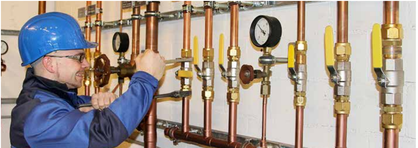
Stefan Fuchs, Monteur bei Messer in der Schweiz, installiert das Leitungssystem der medizinischen Gasversorgung eines Krankenhauses.
